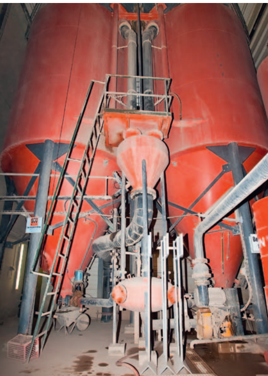
Der Klärreaktor, wo sich der Schlamm setzt.
