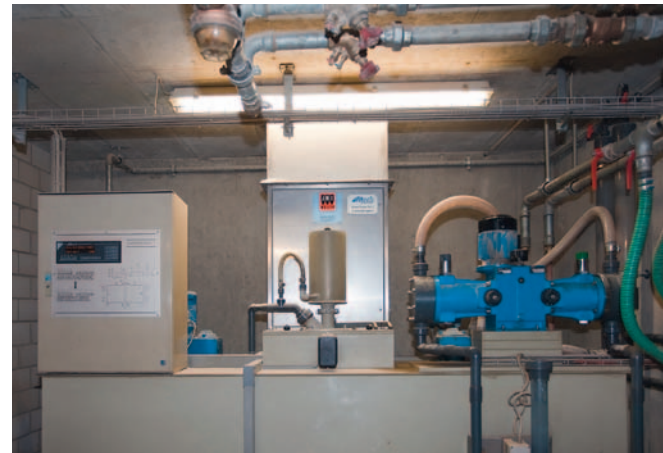
Die Flockungsmittelstation zur Aufbereitung des Flockungsmittels.
